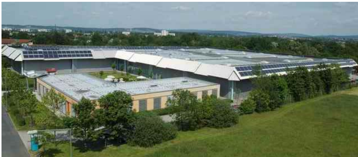
Abbildung 7: 100-kW p -Photovoltaikanlage auf dem Hallendach der Hübner GmbH
